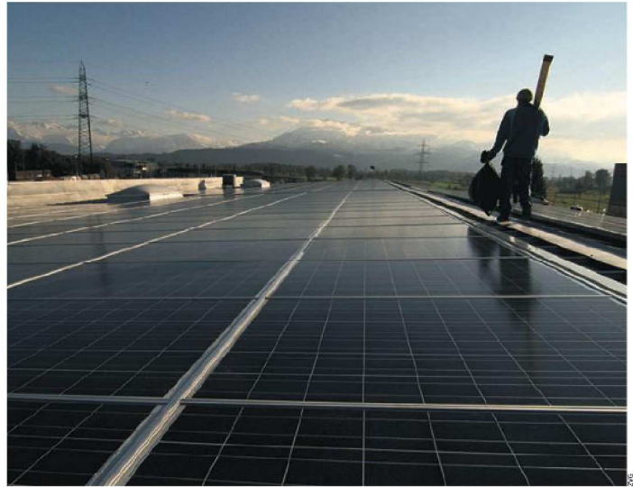
Edisun-Anlage in Rothenburg LU: Die Sonne entscheidet über die Rendite.
